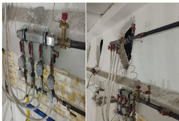
Рис. 4. Внешний вид квартирной станции Ст. 1
